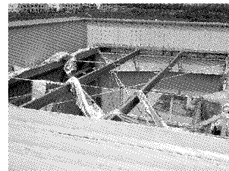
图 1 直立锁缝屋面体系风致破坏
