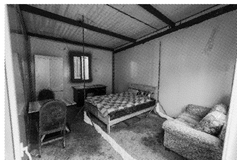
图 3 板房 A4 室内可燃物布置
