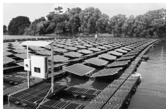
图5 新加坡登格水库(Tengeh Reservoir)浮式光伏测试平台 [20]
