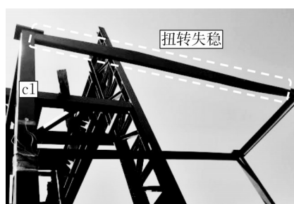
图9 槽钢梁扭转破坏
