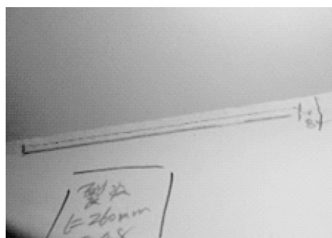
图2 实桥顶板-U肋焊喉裂纹
